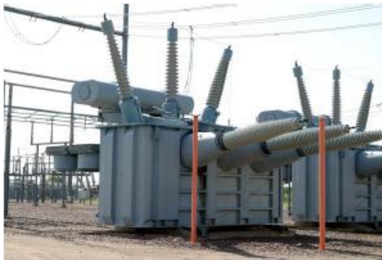
شکل ۱ تصویر نمونه از یک ترانس در شبکه قدرت
